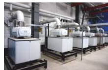
Вакуумная установка электронно-лучевой сварки
